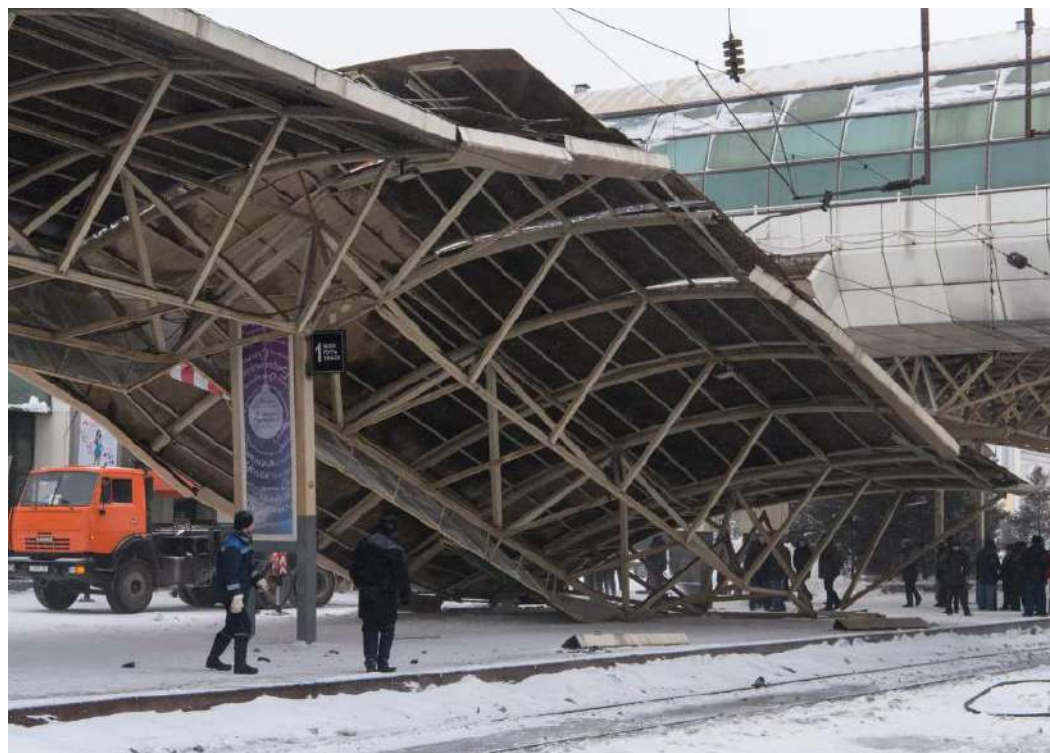
Рисунок 1.10– Обрушение навеса на железнодорожном вокзале (Казахстан)
