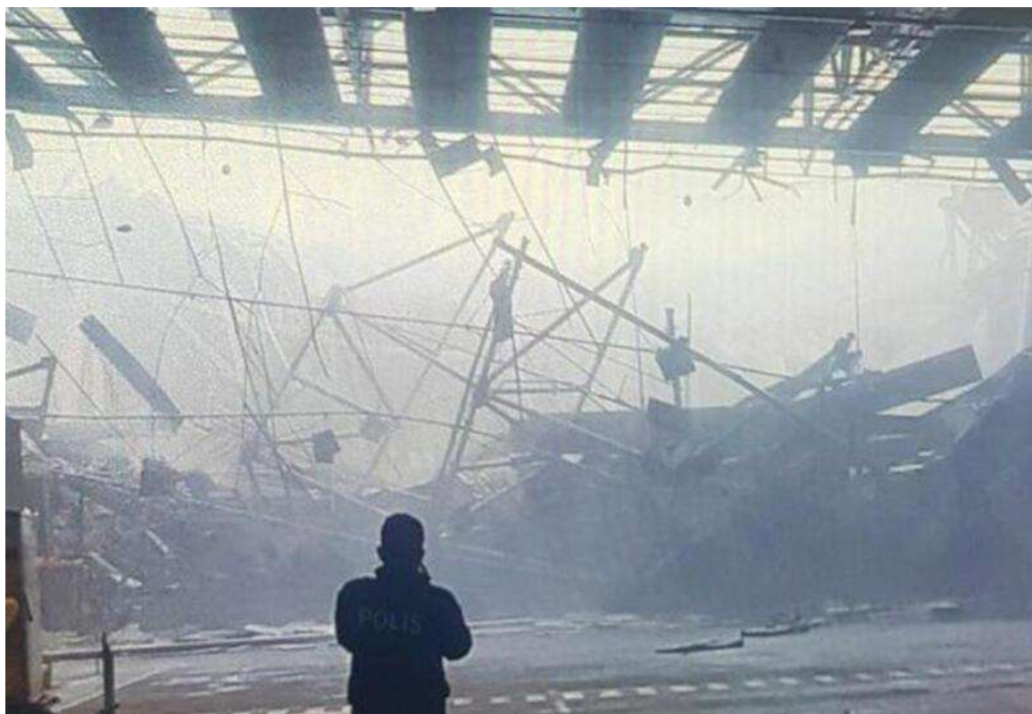
Рисунок 1.15– Обрушение кровли терминала в аэропорту (Турция)
