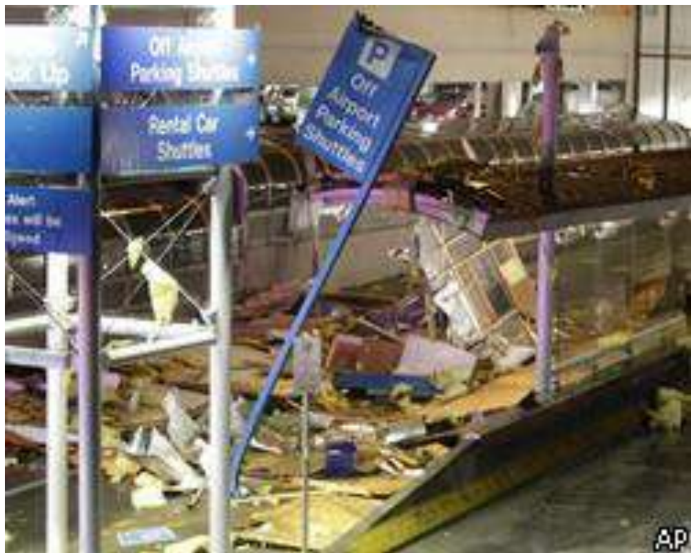
Рисунок 1.7 – Обрушение одного из терминалов аэропорта (США)
