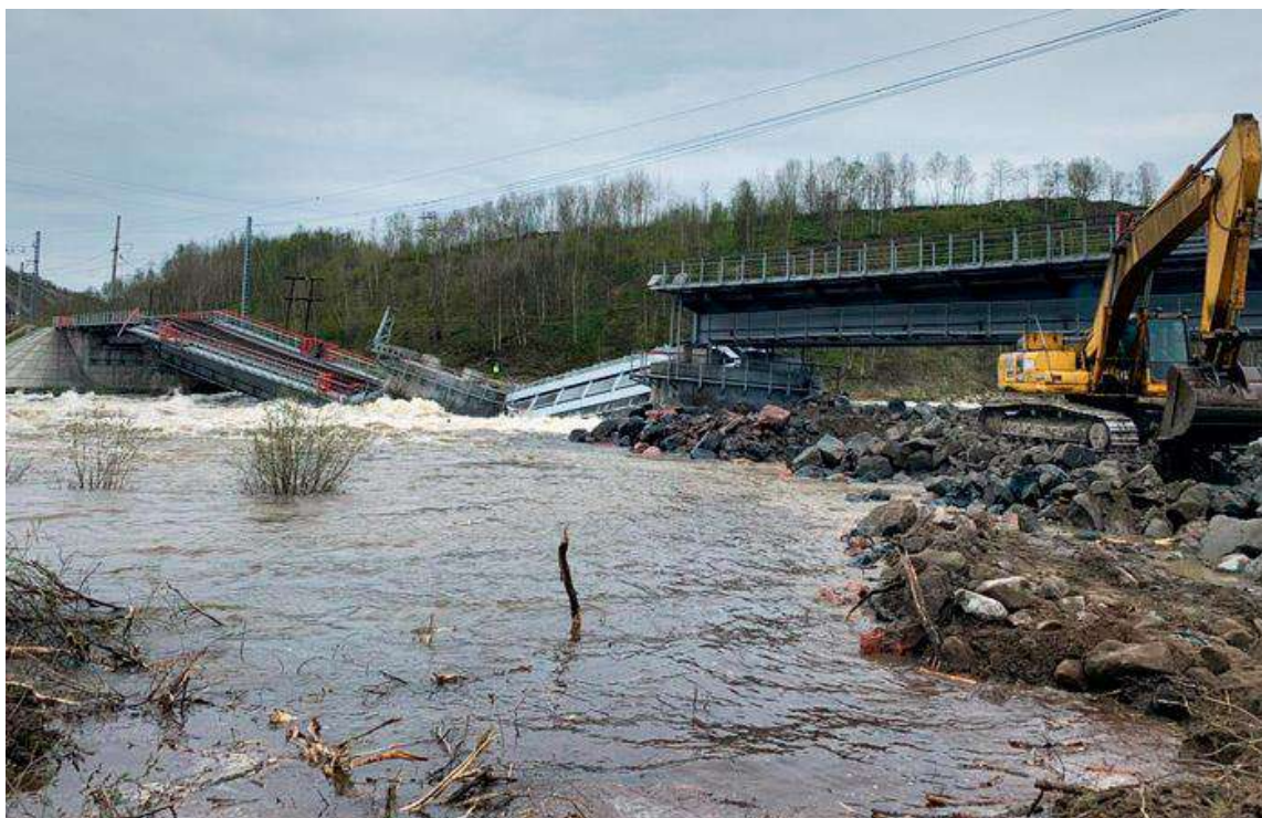
Рисунок 1.3 – Обрушение железнодорожного моста в Мурманской области
