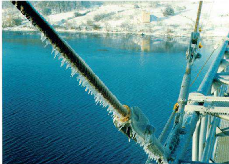
Рисунок 1.23 – Гололедо-изморозевые отложения на канатных элементах подвесок висячего моста аммиакопровода через р. Днепр у г. Днепропетровска
