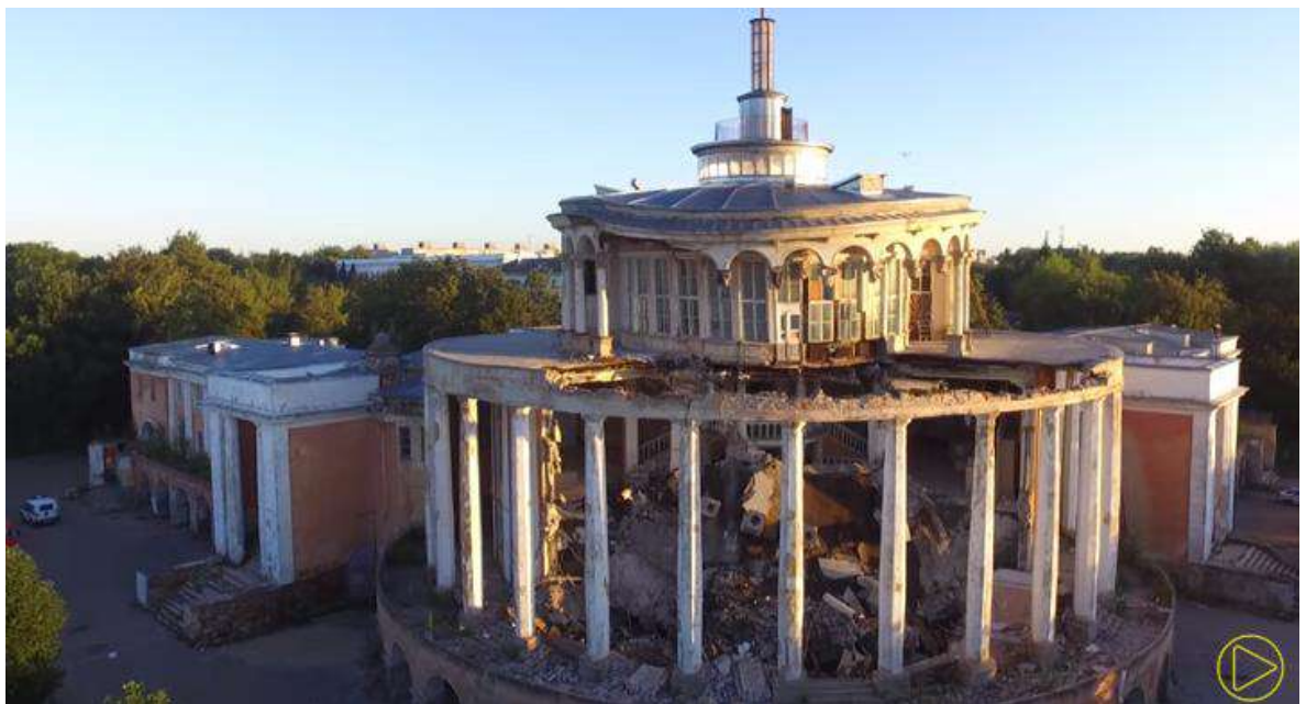
Рисунок 1.9 – Обрушение здания речного вокзала в Твери
