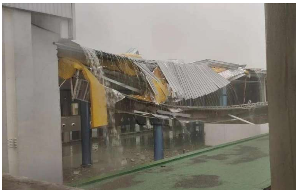
Рисунок 1.13 – Обрушение кровли (Тайланд)
